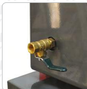
Válvula de dren
